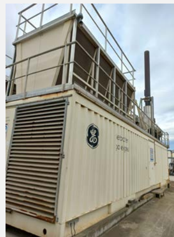
Groupe de cogénération pour la valorisation électrique
