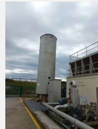
Torchère biogaz relais en cas de dysfonctionnement des unités de valorisation énergétique
